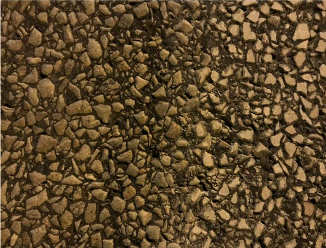
Figur 33. Effekten av slipningen av ABS16 beläggning. Beläggningen till höger är slipad medan den till vänster är utanför hjulspår och därmed obehandlad. Foto: Skanska.
